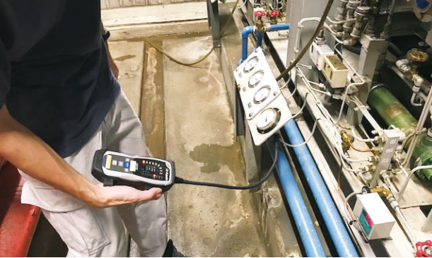
冷媒漏えい点検
