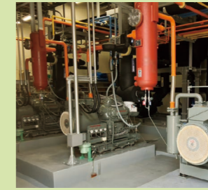
自然冷媒(NH 3 (アンモニア)とCO 2 (二酸化炭素))を使用した冷凍機
