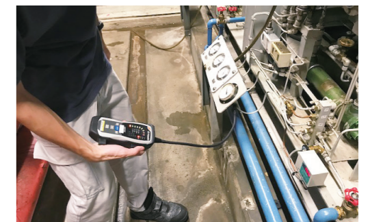
冷媒漏えい点検
